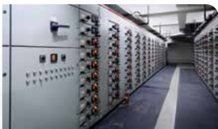
Monitoraggio costante di attrezzature critiche
